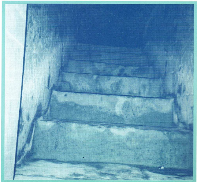
Paso de la acequia por el interior del puente de la canaleta de Luceni.
